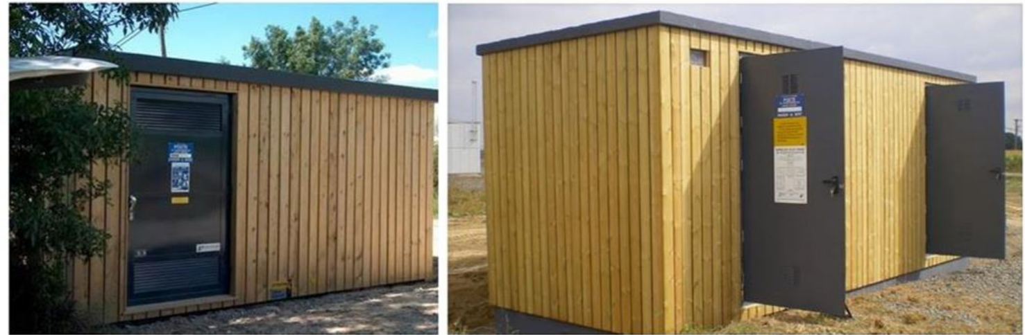
Exemples de postes de livraison avec bardage bois
